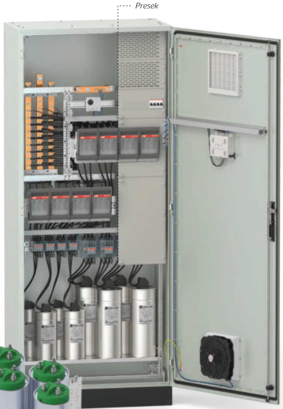
Montaža kondenzatorskih baterija, kontaktora i rastavljača u ormanu KB3/12IP65
