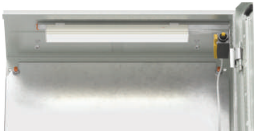
Primer postavljanja lampe i mikro-prekidača u ormanu KB2/6IP65 - Prednji pogled
